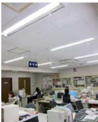
最新の照明器を設置した事務室
