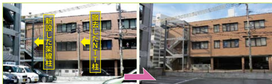
新古賀病院西側のマインドビルと天神会関係者駐車場との間の市道 NTT柱を撤去して、天神会関係者駐車場内に架線柱を新設し、複雑に入り組んでいた架線もすっきり整理して張り替えました。
